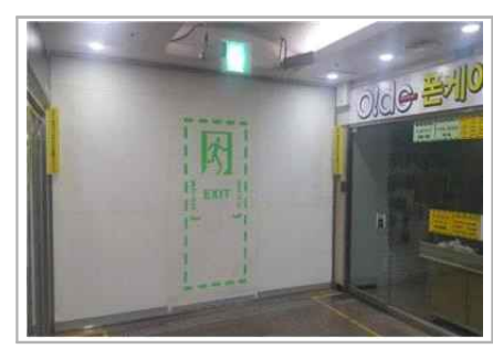
개선 후(방화 스크린)
